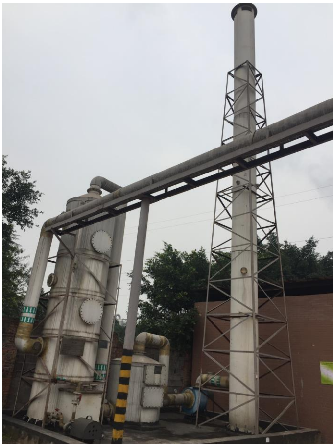
图 4.12 废水处理站尾气处理设施设置情况图
