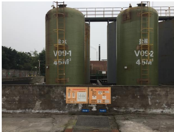
围堰设置雨污切换阀
