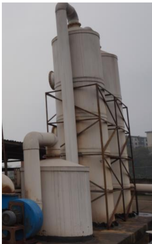
图 4.9 六、七车间不凝废气处理设施设置情况图
