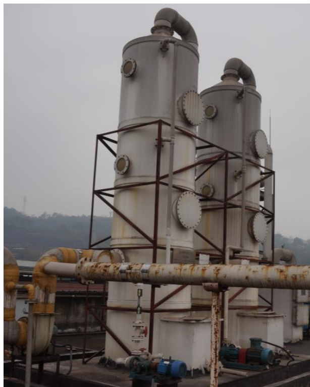
图 4.11 八车间不凝废气处理设施设置情况图
