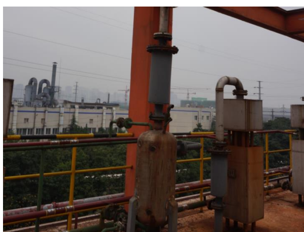
醛肟装置排氢废气排放口
