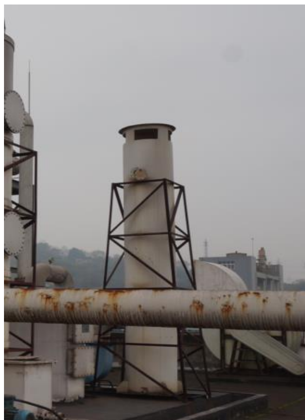
八车间不凝废气废气排放口
