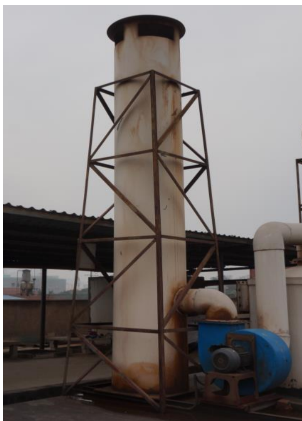
六、七车间不凝废气排放口
