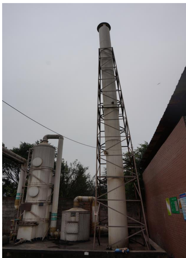
废水处理站废气排放口
