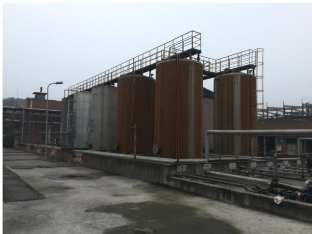
储罐区机泵均设置围堰
