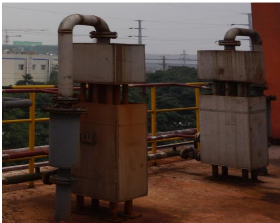
图 4.5 醛肟装置排氢废气处理设施设置情况图
