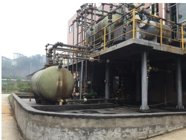
生产车间装置区中间罐设拦截、防渗防腐措施
