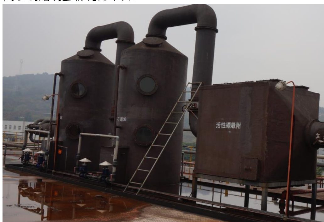
图 4.7 三、四车间不凝废气处理设施设置情况图
