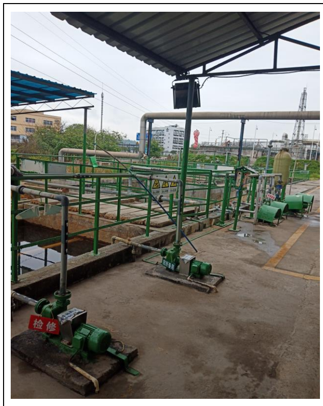
图 4.1 废水处理站设置情况图
