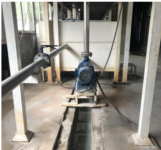
清洗废水排水沟（防渗、防漏、防酸碱腐蚀处理、可视化）；槽体架空，地面防腐防渗
