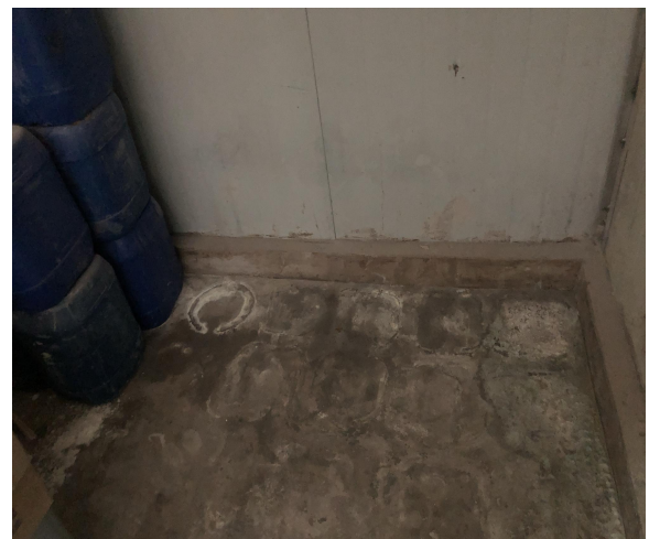
液态辅料暂存库（防腐防渗、围堰）
