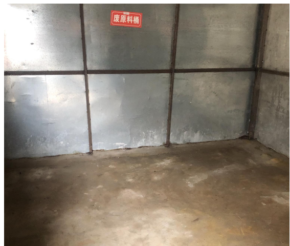
危废暂存间（防腐防渗、围堰）
