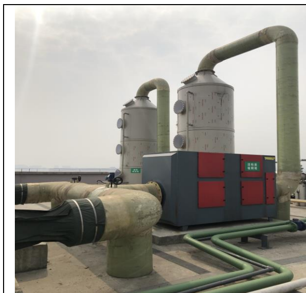
废气处理设施
