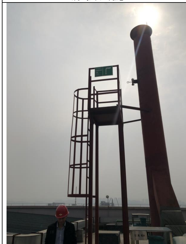
工艺废气排放口
