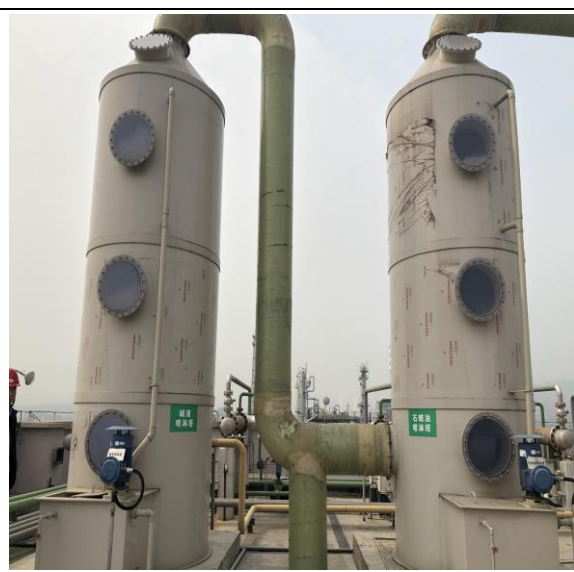
废气处理设施
