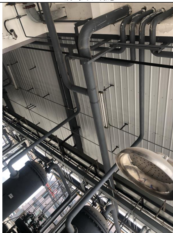
车间废气收集管道
