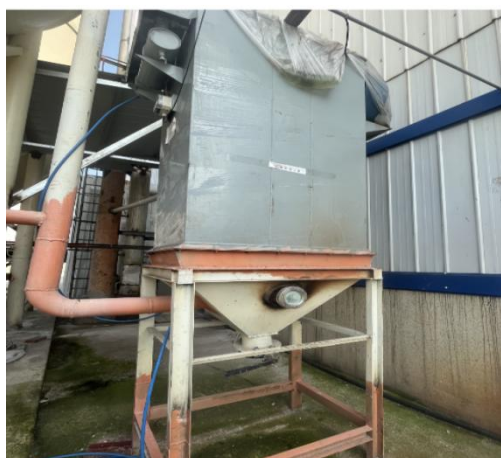
石灰石投料布袋除尘器
