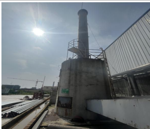
旋风除尘器+湿式洗涤塔（复合肥、磷酸盐车间）
