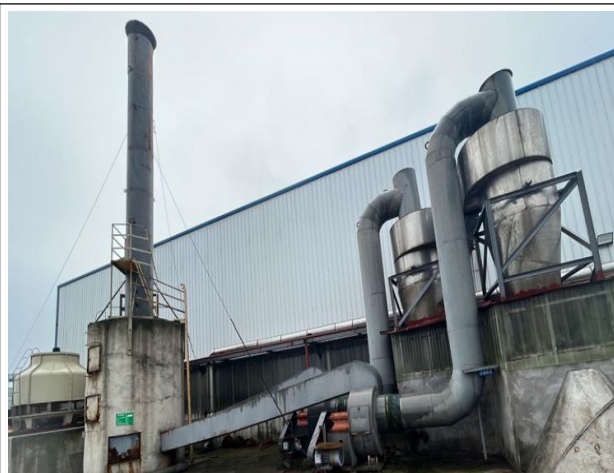
旋风除尘器+湿式洗涤塔（硝酸铵钙车间）
