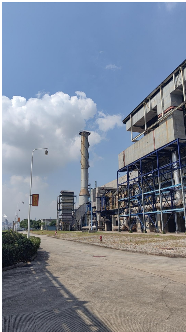
CO 2 吸收塔废气排气筒
