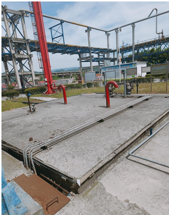
装置区废水收集池
