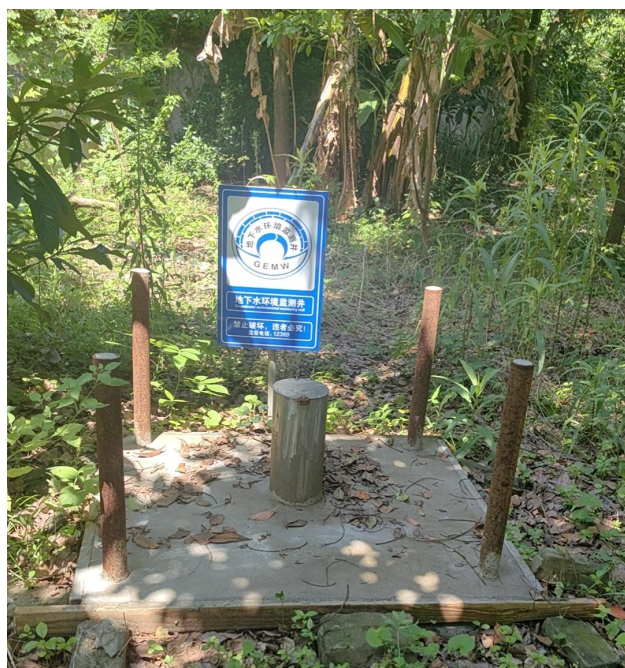
地下水监控井
