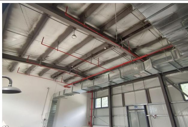
危险废物暂存间设喷淋系统（依托）
