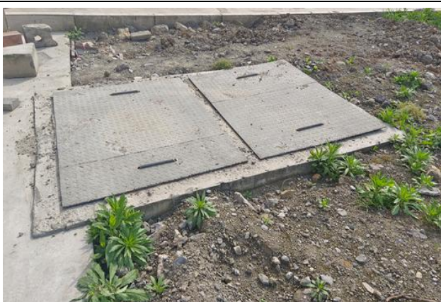
危险废物间外收集井（依托）
